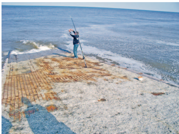
Abb. 1: Schädigung von Beton durch die Einwirkung von Meerwasser
